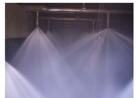
BICO UM-6 EM TORRE DE LAVAGEM DE GASES
